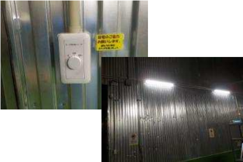
③使用エネルギー削減の取り組み 資材置き場の照明を人感センサー式に変更
